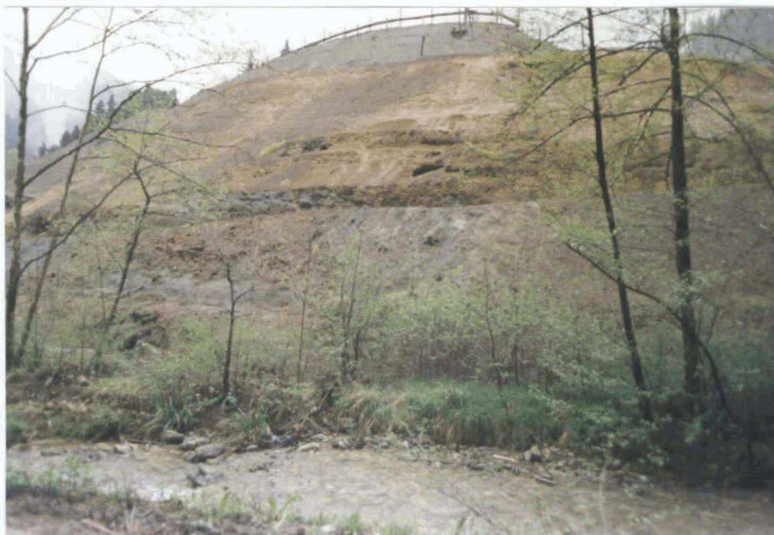
FOTO N° 4: Erosiones y deslizamientos sobre el talud de la balsa de Legorreta, cuyo pié es lamido por las aguas de un arroyo.
