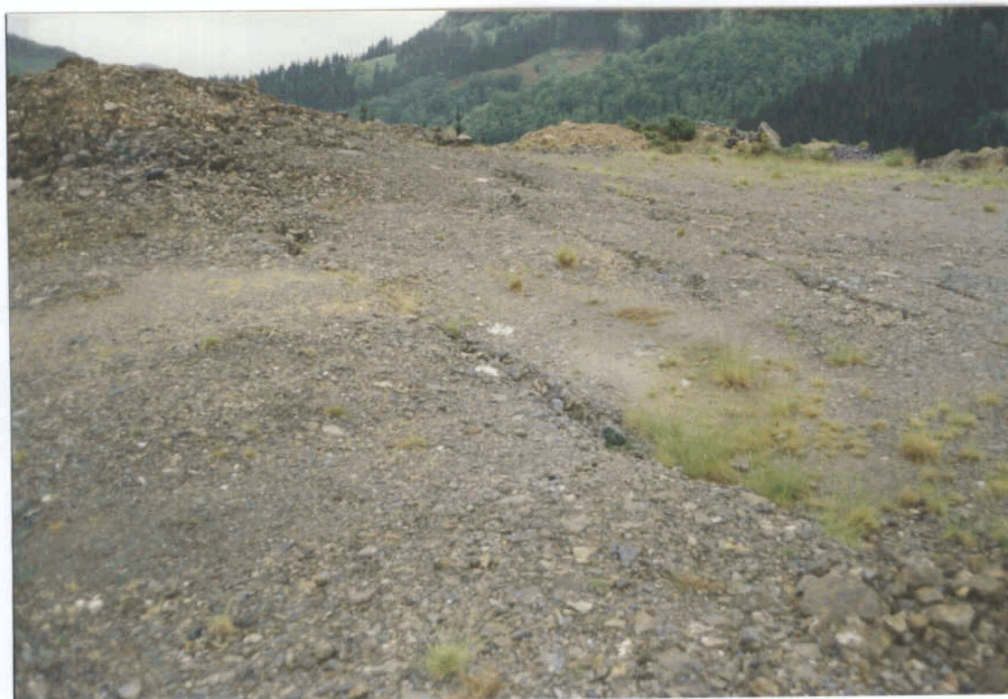
FOTO Nº 8: Detalle de grietas longitudinales en superficie de escombrera en Arditurri.
